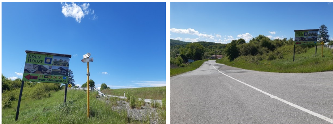
Obrázok 103 Predmetné poškodené cyklosmerovky
