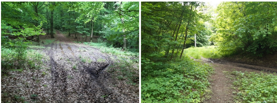
Obrázok 136 Poškodená účelová komunikácia
