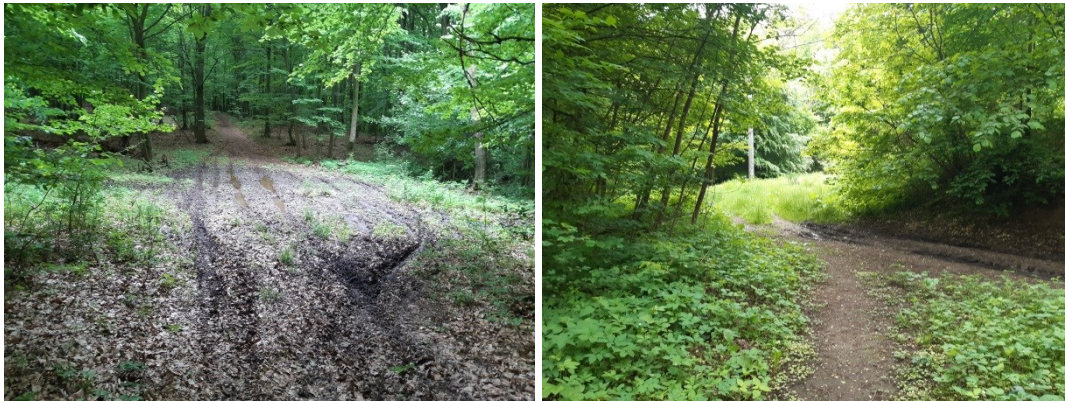
Obrázok 309 Poškodená účelová komunikácia
