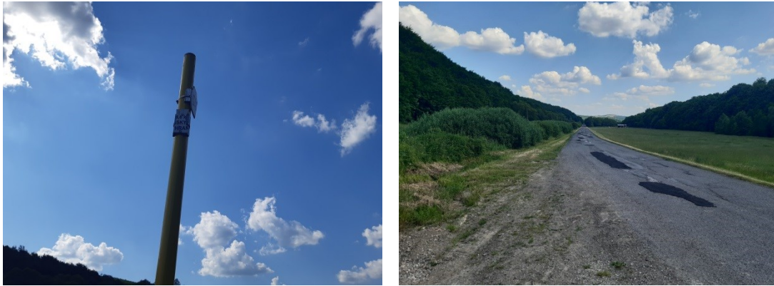
Obrázok 194 Predmetné poškodené cyklosmerovky
