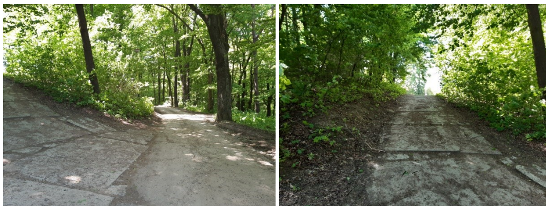
Obrázok 85 Nevhodný povrch komunikácií
