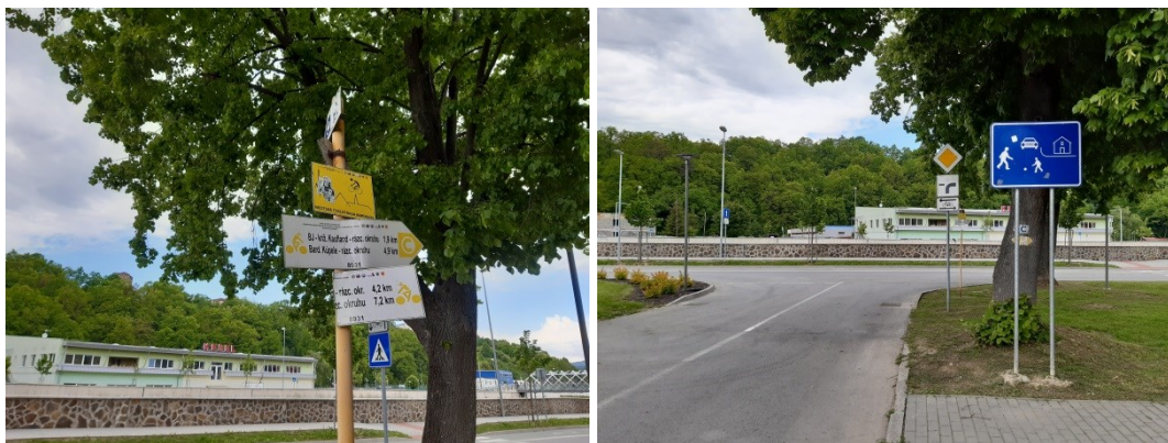
Obrázok 54 Predmetné poškodené cyklosmerovky
