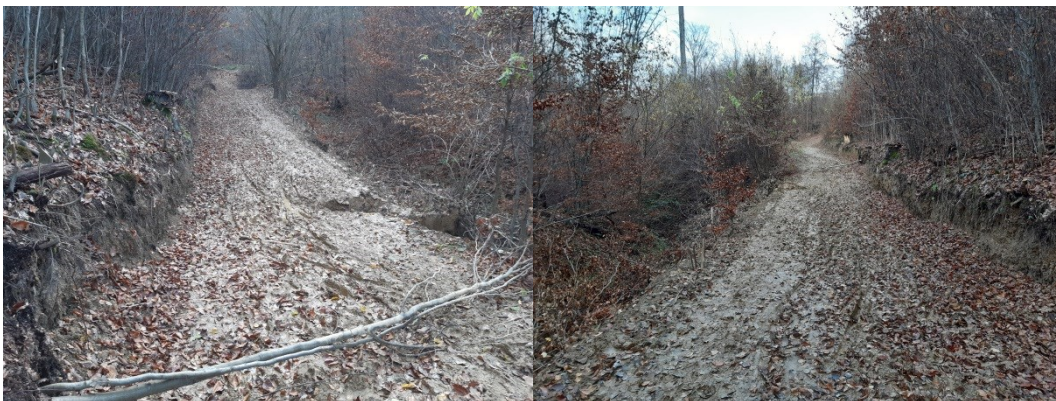
Obrázok 29 Poškodená komunikácia na cyklotrase
