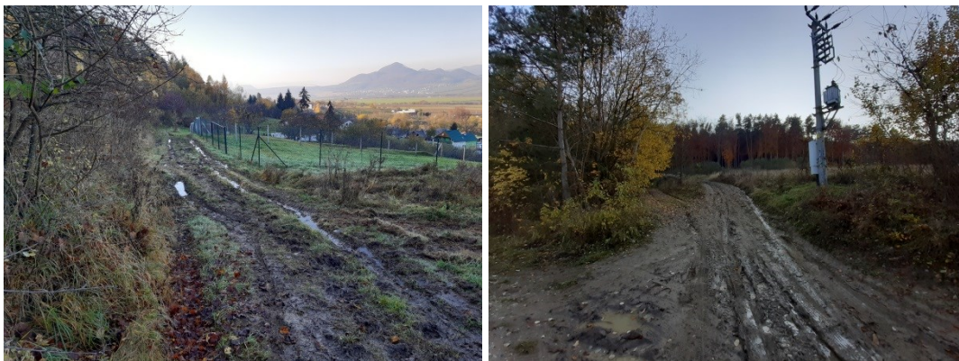
Obrázok 50 Poškodené účelové komunikácie medzi Okružnou a Vyšnou Šebestovou
