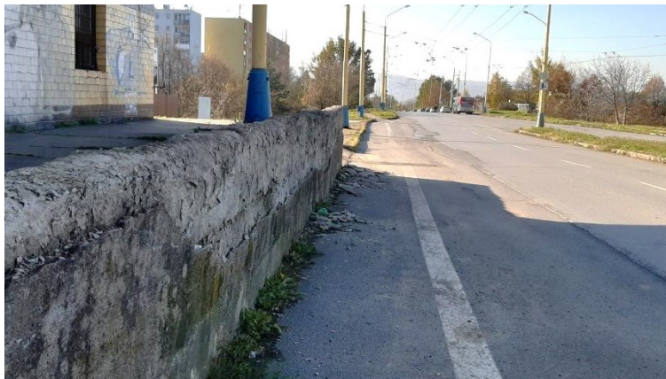
Obrázok 109 Poškodený oporný múr
