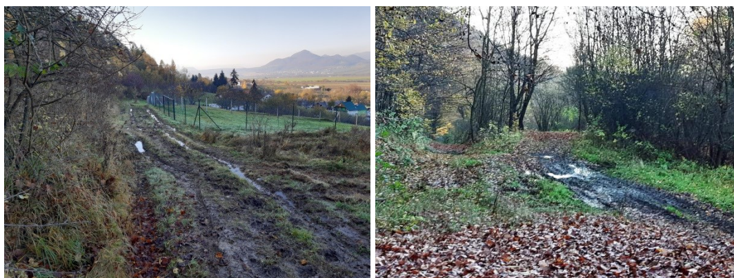
Obrázok 48 Poškodené účelové komunikácie medzi Okružnou a Vyšnou Šebestovou
