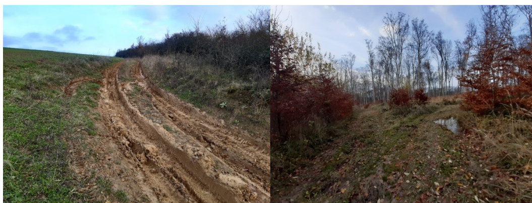
Obrázok 31 Najviac poškodené úseky komunikácie
